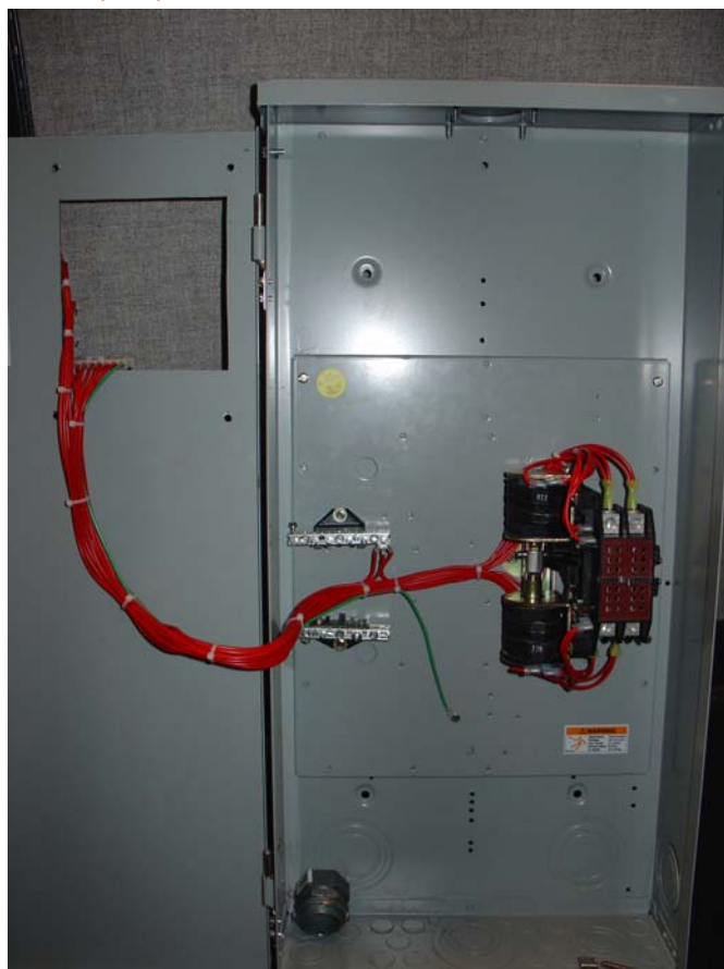
Figure 6 - Panneau électrique typique du modèle de 100 A
