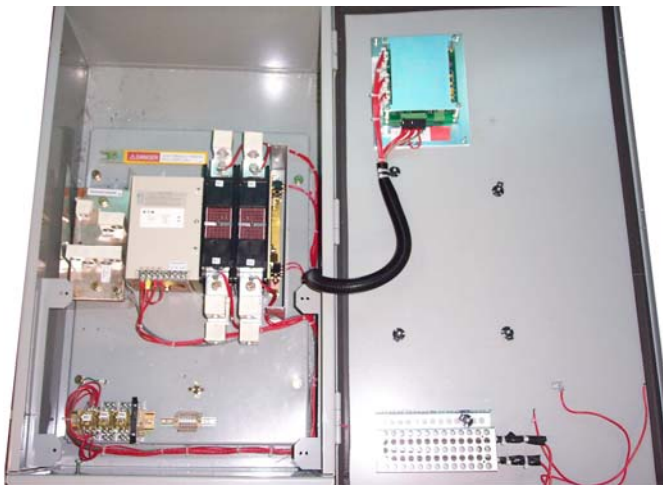
Figure 5 - Panneau électrique typique d'un commutateur de 400 A
